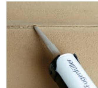
Füllung eines Abrisses zwischen Decken- und Wandbauteil
