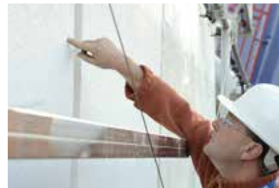
Bei der optischen Beurteilung nach Prüfung durch den sachverständigen Prüfer muss das WDV-System schadensfrei, also ohne Risse sein.
